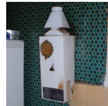
Absence de dispositif d'évacuation des gaz brûlés
