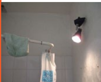
Branchement électrique dangereux
