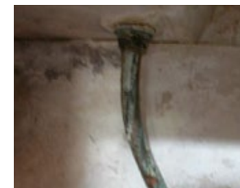
Absence de siphon
