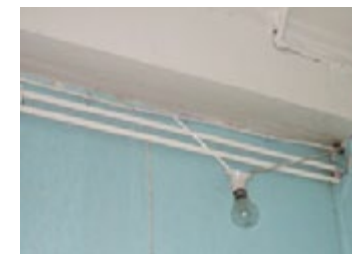
Eclairage insuffisant et dangereux
