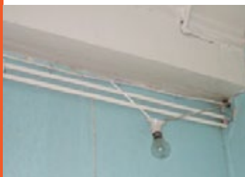
Installation électrique dangereuse
