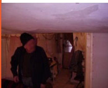
Hauteur sous plafond insuffisante
