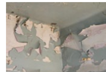
Peinture écaillée contenant du plomb
