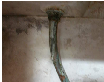
Absence de siphon
