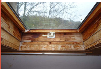
Absence de protection contre les infiltrations d'eau
