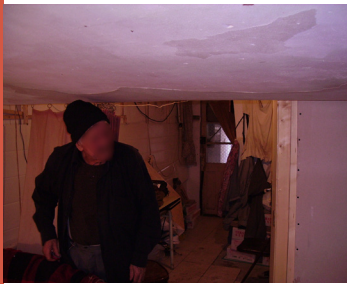
Hauteur sous plafond insuffisante
