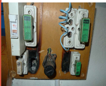
Branchements d'électricité vétustes
