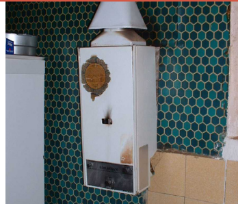
Absence de dispositif d'évacuation des gaz brûlés
