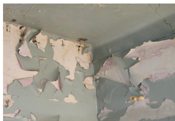
Peinture écaillée contenant du plomb
