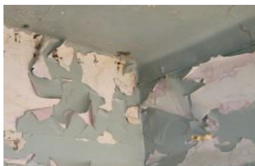
Peinture écaillée contenant du plomb
