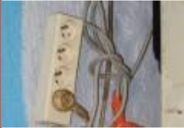
Installation électrique dangereuse
