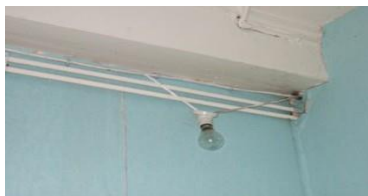
Eclairage insuffisant et dangereux
