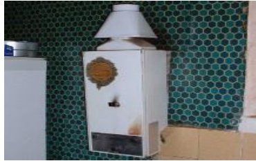
Absence de dispositif d'évacuation des gaz brûlés
