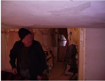
Hauteur sous plafond insuffisante
