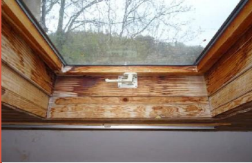
Absence de protection contre les infiltrations d'eau
