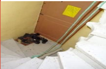
Absence de dispositifs de retenue des personnes
