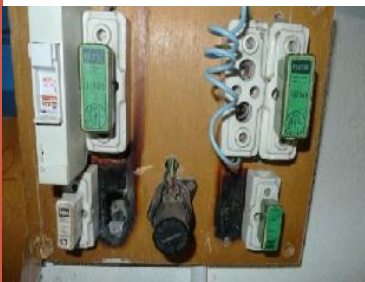
Branchements d'électricité vétustes
