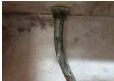
Absence de siphon
