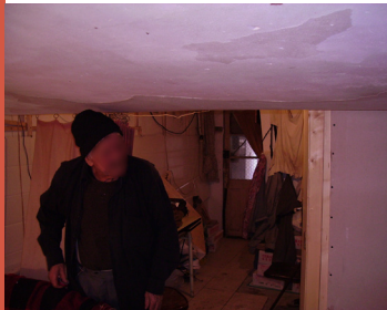
Hauteur sous plafond insuffisante
