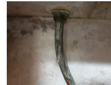
Absence de siphon
