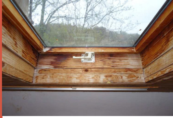
Absence de protection contre les infiltrations d'eau
