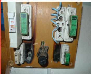
Branchements d'électricité vétustes
