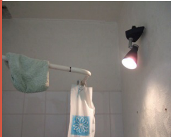
Branchement électrique dangereux
