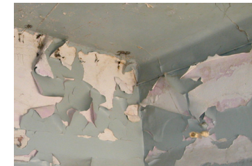
Peinture écaillée contenant du plomb
