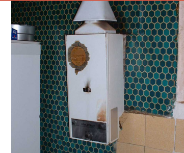
Absence de dispositif d'évacuation des gaz brûlés
