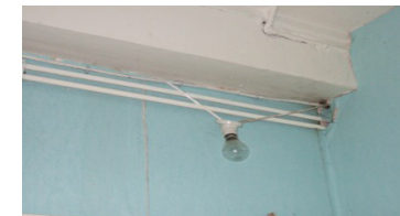
Eclairage insuffisant et dangereux
