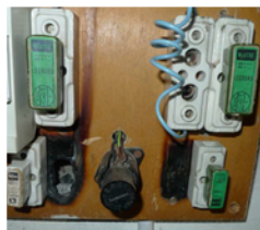
Branchements d'électricité vétustes
