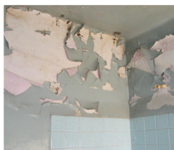
Peinture écaillée contenant du plomb
