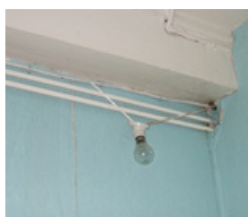
Éclairage insuffisant et dangereux
