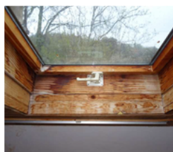
Absence de protection contre les infiltrations d'eau
