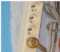
Installation électrique dangereuse
