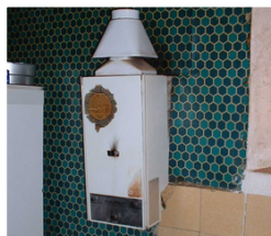
Absence de dispositif d'évacuation des gaz brûlés
