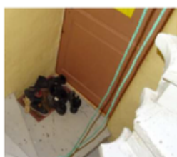
Absence de dispositifs de retenue des personnes
