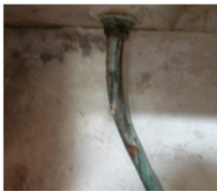
Absence de siphon
