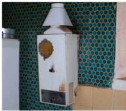
Absence de dispositif d'évacuation des gaz brûlés
