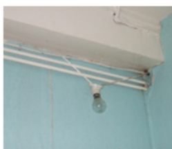
Éclairage insuffisant et dangereux
