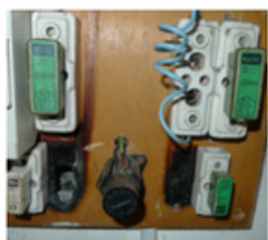
Branchements d'électricité vétustes
