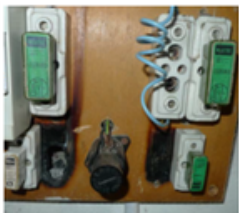
Branchements d'électricité vétustes
