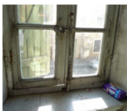
Menuiserie en mauvais état
