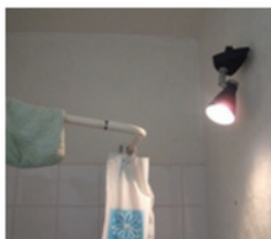
Branchement électrique dangereux
