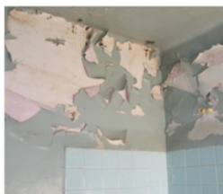
Peinture écaillée contenant du plomb
