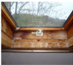
Absence de protection contre les infiltrations d'eau
