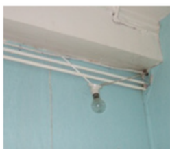
Éclairage insuffisant et dangereux
