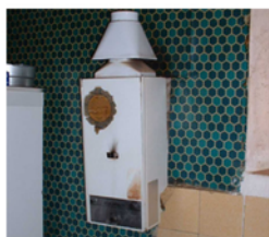
Absence de dispositif d'évacuation des gaz brûlés
