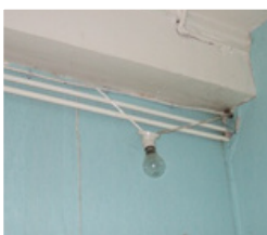
Éclairage insuffisant et dangereux
