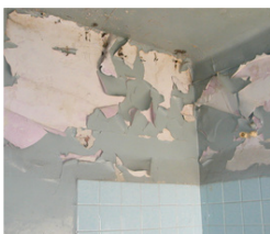
Peinture écaillée contenant du plomb
