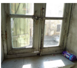
Menuiserie en mauvais état
