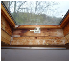
Absence de protection contre les infiltrations d'eau
