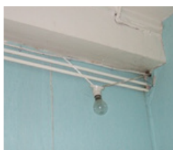
Éclairage insuffisant et dangereux
