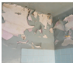
Peinture écaillée contenant du plomb
