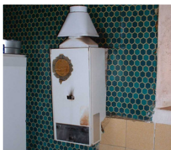
Absence de dispositif d'évacuation des gaz brûlés
