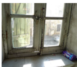
Menuiserie en mauvais état
