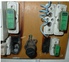
Branchements d'électricité vétustes
