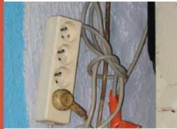
Installation électrique dangereuse
