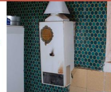
Absence de dispositif d'évacuation des gaz brûlés
