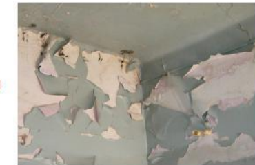
Peinture écaillée contenant du plomb
