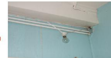
Eclairage insuffisant et dangereux
