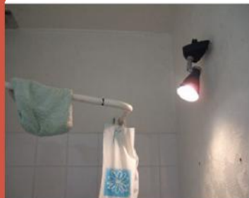
Branchement électrique dangereux
