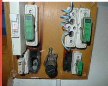
Branchements d'électricité vétustes
