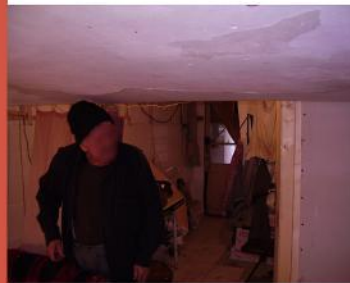
Hauteur sous plafond insuffisante
