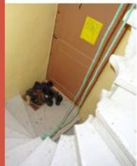
Absence de dispositifs de retenue des personnes
