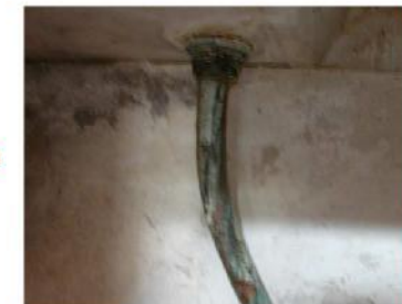
Absence de siphon
