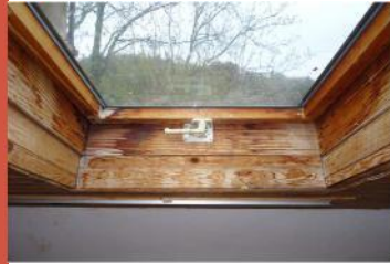
Absence de protection contre les infiltrations d'eau
