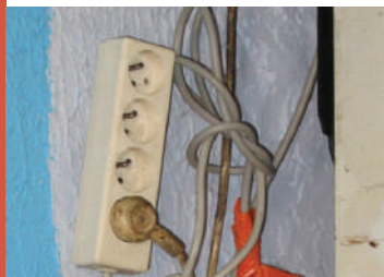
Installation électrique dangereuse
