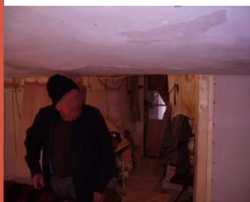
Hauteur sous plafond insuffisante
