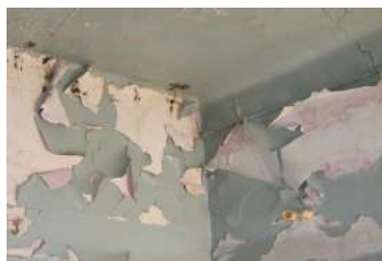
Peinture écaillée contenant du plomb
