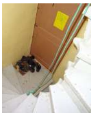
Absence de dispositifs de retenue des personnes
