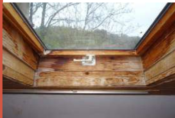
Absence de protection contre les infiltrations d'eau
