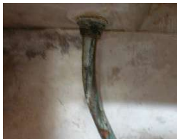
Absence de siphon
