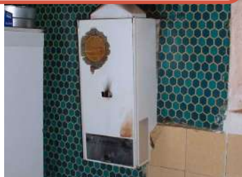
Absence de dispositif d'évacuation des gaz brûlés
