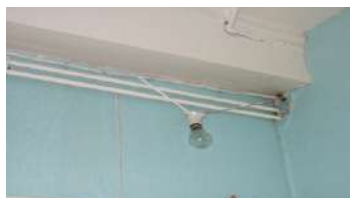
Eclairage insuffisant et dangereux
