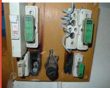
Branchements d'électricité vétustes
