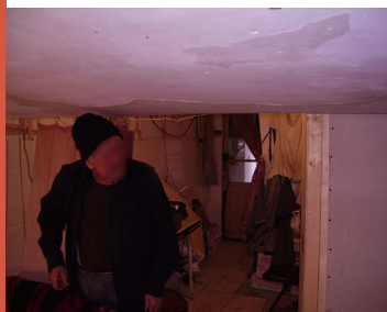
Hauteur sous plafond insuffisante
