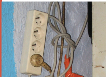
Installation électrique dangereuse
