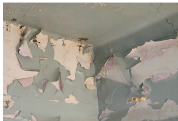
Peinture écaillée contenant du plomb
