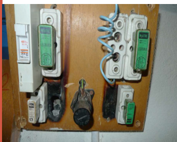
Branchements d'électricité vétustes
