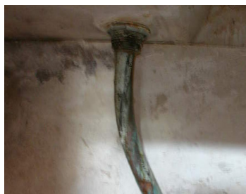
Absence de siphon
