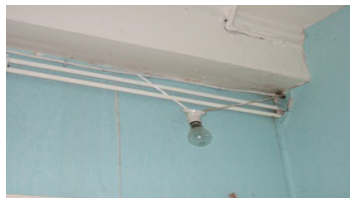
Eclairage insuffisant et dangereux
