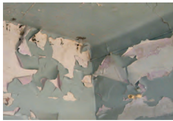
Peinture écaillée contenant du plomb
