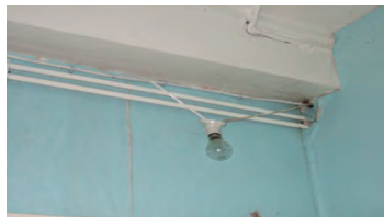
Eclairage insuffisant et dangereux
