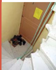
Absence de dispositifs de retenue des personnes
