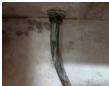
Absence de siphon sous l'évier
