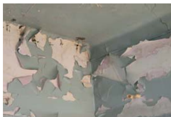
Peinture écaillée contenant du plomb
