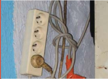
Installation électrique dangereuse
