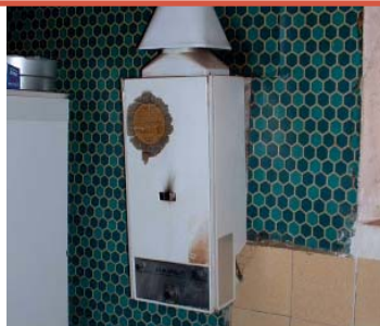
Absence de dispositif d'évacuation des gaz brûlés
