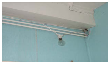
Eclairage insuffisant et dangereux
