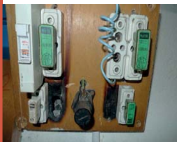
Branchements d'électricité vétustes
