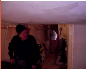
Hauteur sous plafond insuffisante
