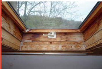
Absence de protection contre les infiltrations d'eau
