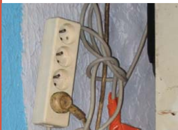
Installation électrique dangereuse
