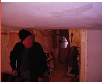
Hauteur sous plafond insuffisante
