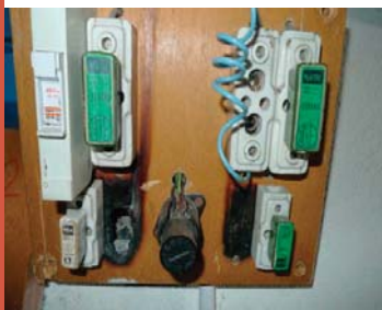
Branchements d'électricité vêtustes
