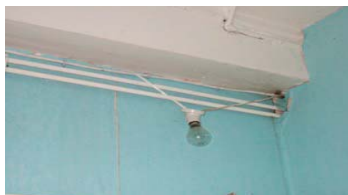
Eclairage insuffisant et dangereux
