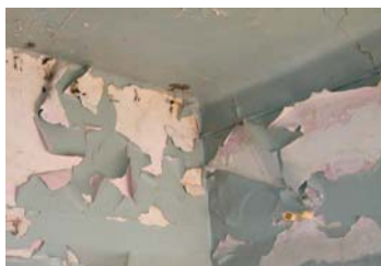
Peinture écaillée contenant du plomb
