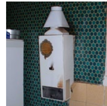
Absence de dispositif d'évacuation des gaz brûlés
