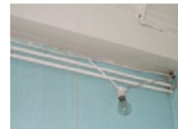
Eclairage insuffisant et dangereux
