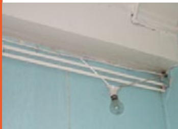
Installation électrique dangereuse
