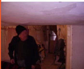
Hauteur sous plafond insuffisante
